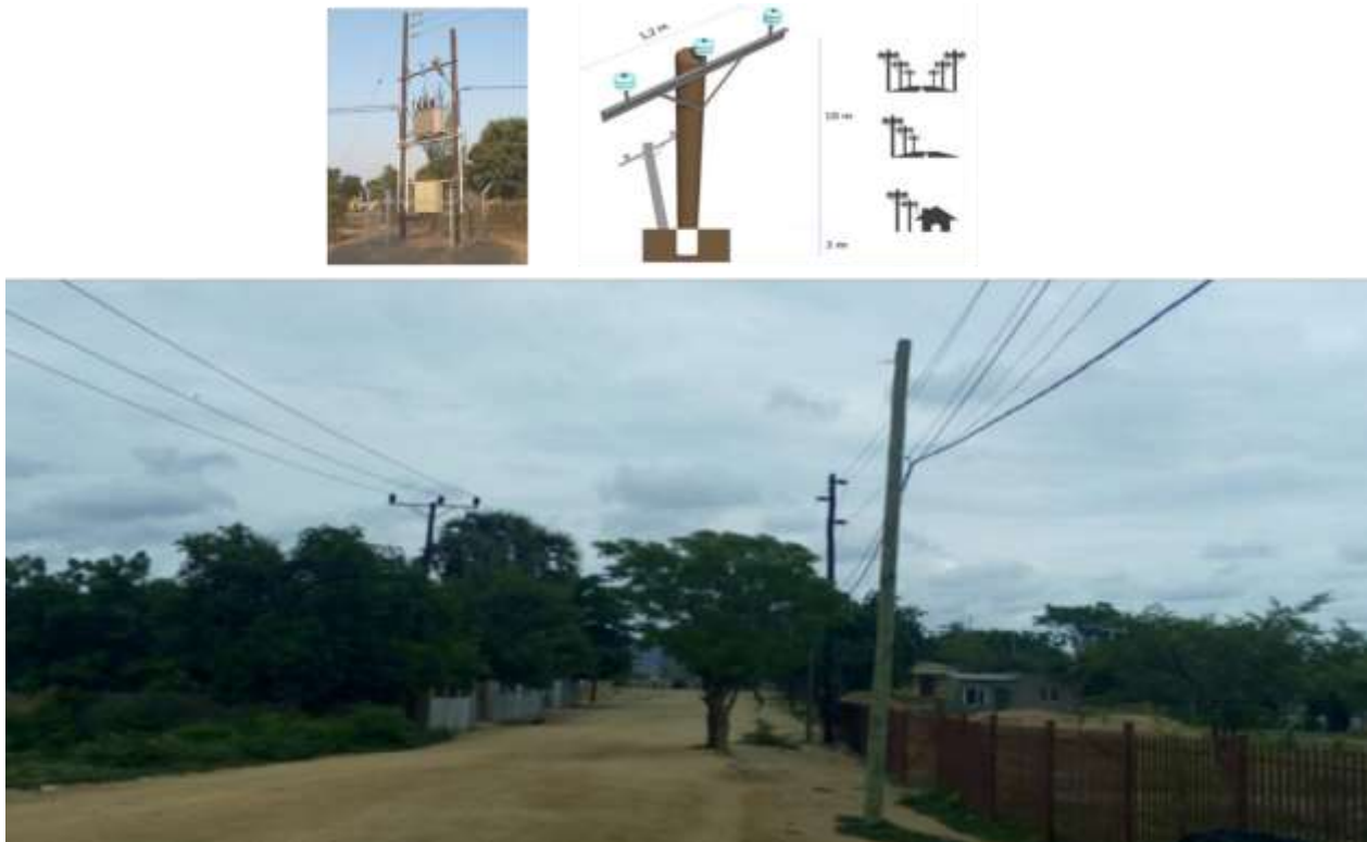
Figura 2-3: Postes de 0.4 e 33 kV similares aos previstos no ProEnergia
