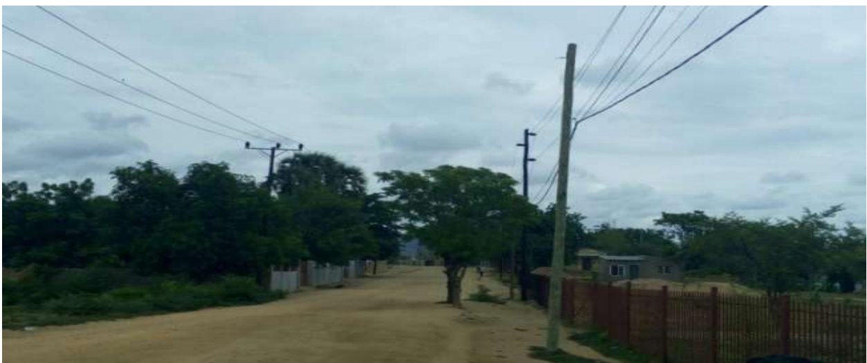
Figura 3.2: Linhas de distribuição de energia em média e baixa tensão – sem observância de ZPP para levar energia aos consumidores
